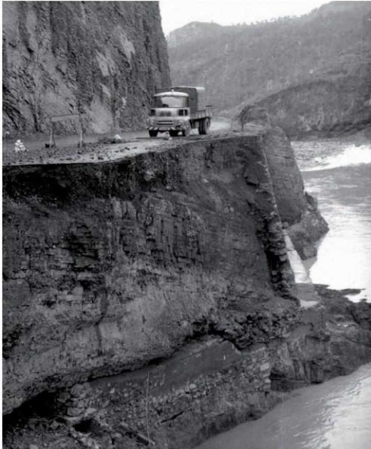
Carretera Cirat-Montanejos (Castellón). 1967 Socavamiento de la ladera por zapa. Avenida del río Mijares
